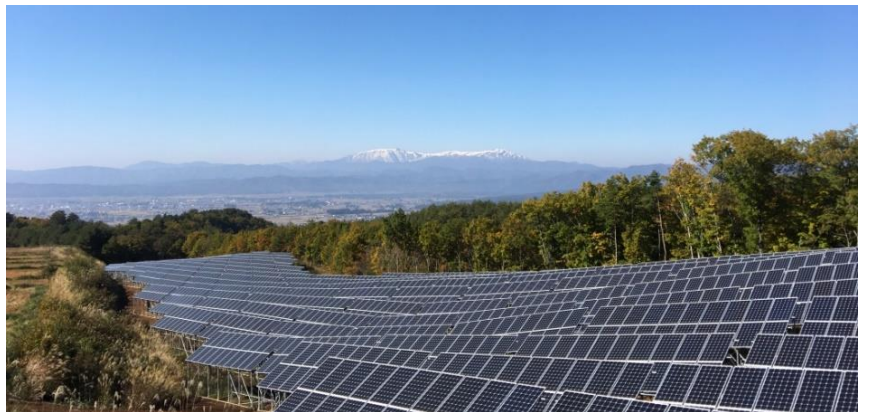
会津電力 雄国太陽光発電所（喜多方市）
